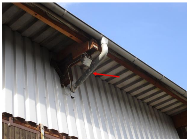
Abb. 15: Vogelkotspuren an Dachrinne (Stand 2021)
